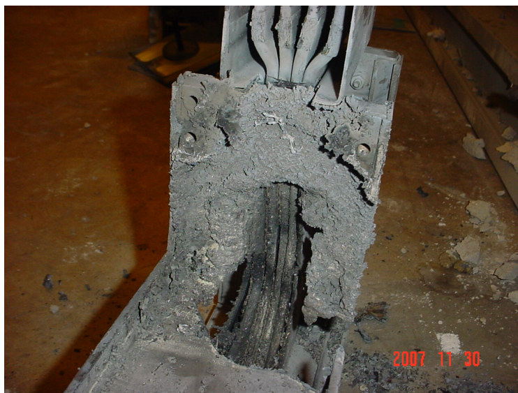
Imagen 9.1.1. Vista de un elemento conductor eléctrico tipo electrobarra que ha pasado por un fallo por sobrecalentamiento que debilitó el aislante propiciando la formación de arcos entre las 3 fases vivas y carcasa.
