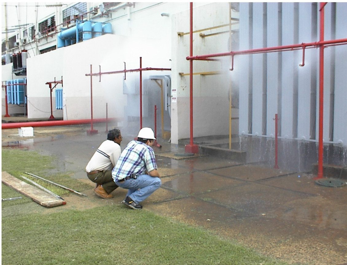
Imagen 4.8.3.3.1 Verificación del sistema de “Water Spray” de transformadores de potencia eléctrica de una planta generadora.
