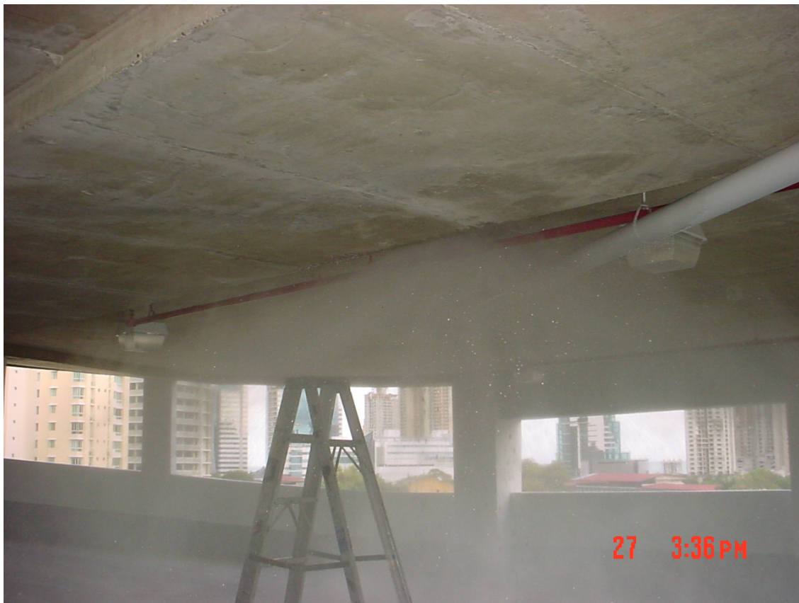
Imagen 4.8.2.2. Se muestra la activación de un rociador en el momento de una prueba para el sistema de un edificio de gran altura. Se puede observar el patrón cónico de rocío.
