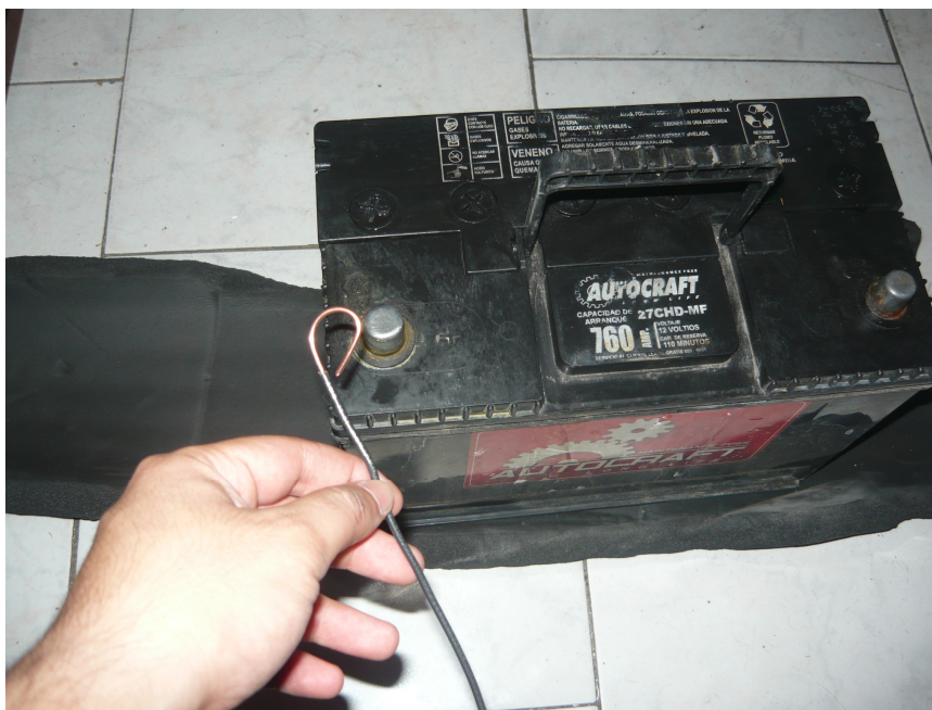
Imagen 7.3.1. Terminal de conexión a la fuente de energía fabricado con alambre sólido #12 AWG
